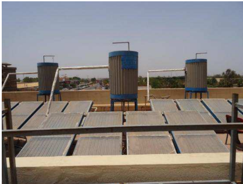
Figure 11. Chauffe-eau classiques fabriqués et installés par une entreprise locale sur le toit d'un hôtel à Ouagadougou.
